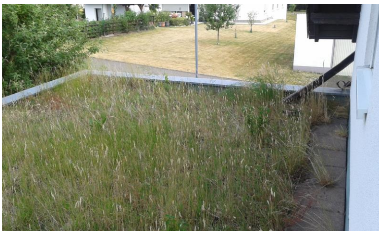
Bild 12: Zustand des Gründachs am 23. Juni 2017 nach langer Trockenheit. Siehe zum Vergleich die Färbung der Rasenfläche im Hintergrund (rechts im Bild der Zufluss vom Steildach)
