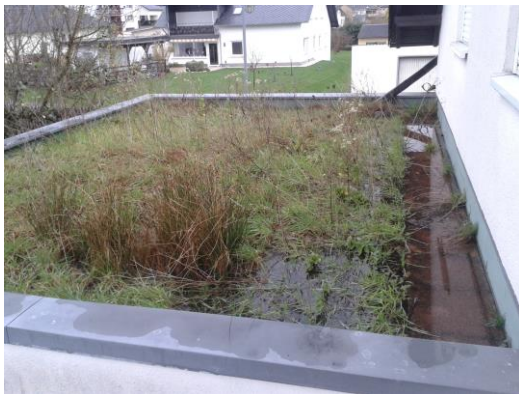
Bild 8: Gründach nach knapp 31 mm Niederschlag in ca. 3 Tagen (rechts im Bild der Zufluss vom Steildach)
