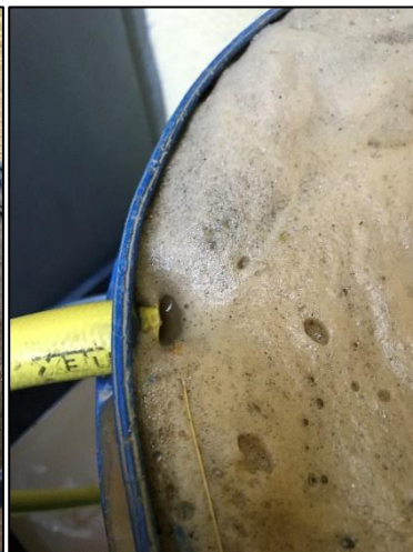
Abb. 14.7: Rückspülablauf in Betrieb
